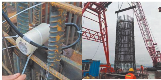
(b) 东吾洋大桥桩基腐蚀监测
