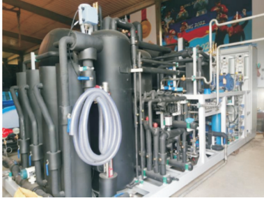
图3 二氧化碳制冷系统测试平台
