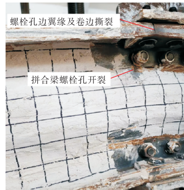
(a) 螺栓孔开裂
