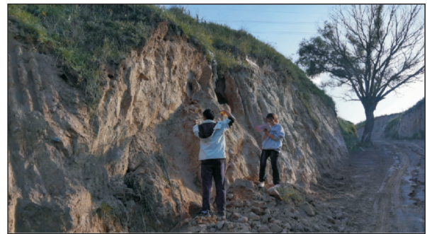
b 边坡侵蚀
