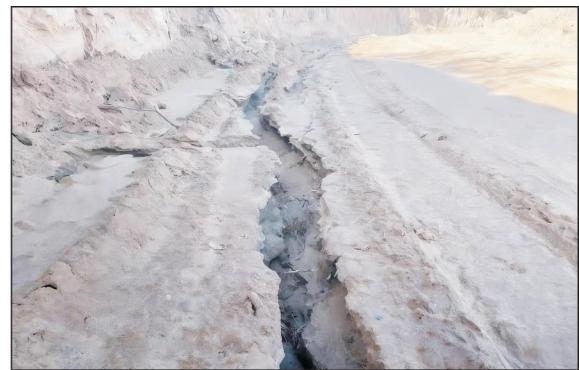
b 黄土路面侵蚀
