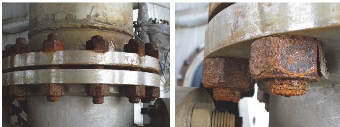
图1 法兰结构腐蚀现象
