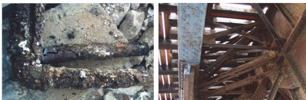
图1 (a) 锈蚀的地下暖气管道; (b) 锈蚀的美国波士顿铁路桥
