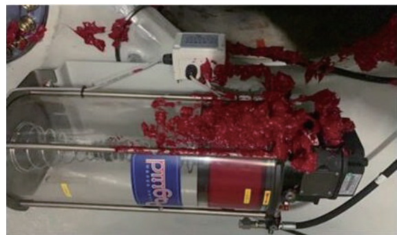
图 11 A3 号风机润滑油泄露现场图
