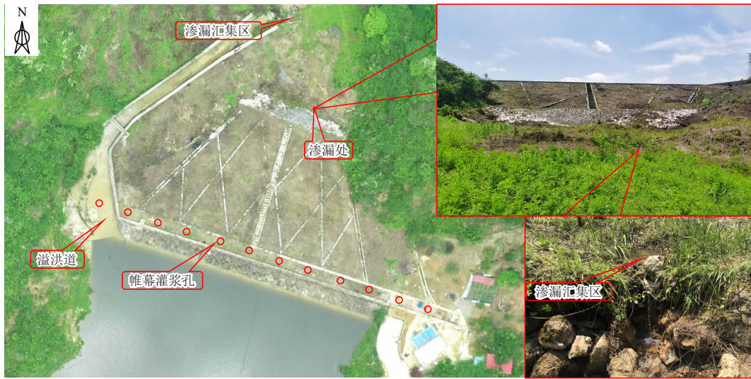
图 1 水库坝体渗漏现状图 Fig. 1 Diagram of reservoir dam leakage status
