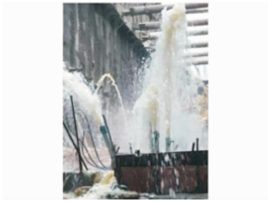
图 12 基坑涌水情况 [7]
