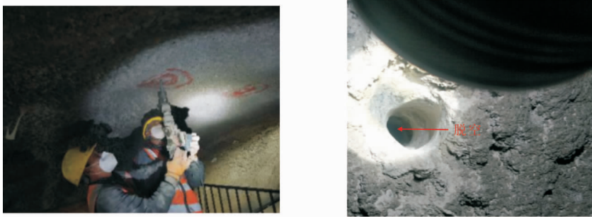
图 14 隧道初支脱空缺陷开孔验证
