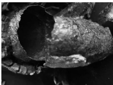
图 6 天然气管道锈蚀断裂
