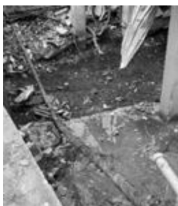
图 5 垮落的天然气管道
