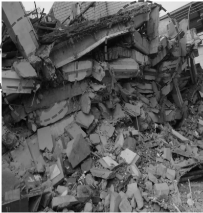
图 10 梁柱节点破坏形态
