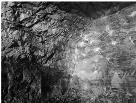
图14 隧道拱肩炮痕
