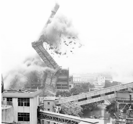
(a) 烟囱三次折叠爆破 (广州, 2005 年) (a) Fold implosion of a chimney (Guang Zhou, 2005)
