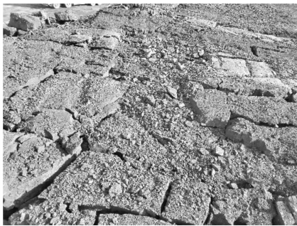
图 18 煤层顶板破坏情况
