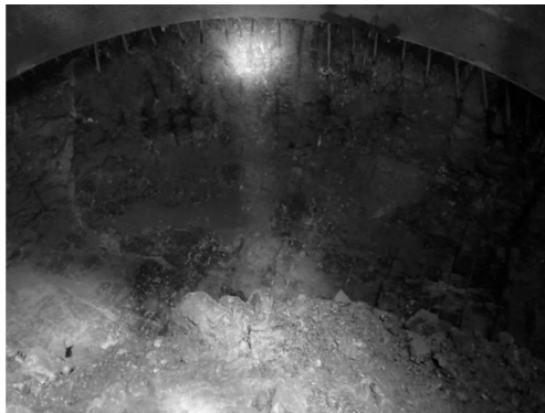
图 1 隧道顶部存在夹泥的不良地质条件 Fig. 1 Adverse geological conditions of mud trapping on the tunnel roof
