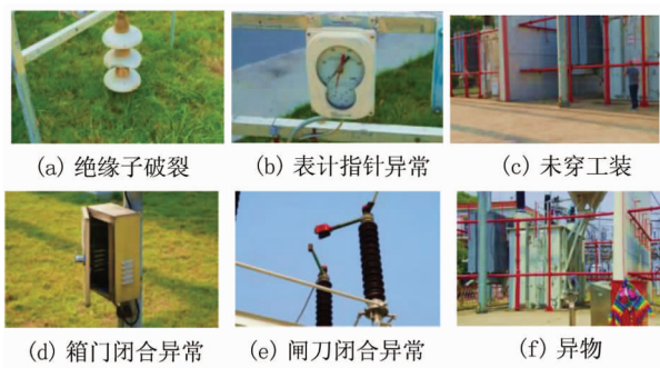
图5 真实场景下变电站设备6类缺陷图像示例
