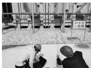
图1 某500 kV变电站主变噪声采集现场
