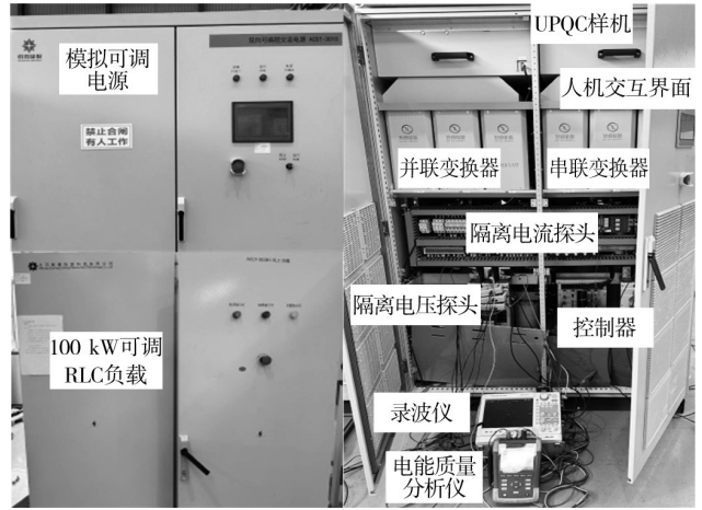
图8 UPQC 实物试验平台
