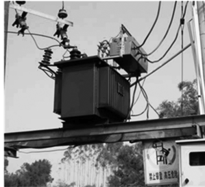
图 3 某节点的故障现场
