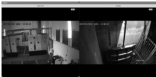
图7 排涝泵站现场实时视频画面
