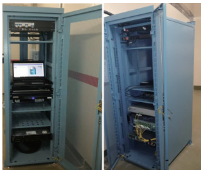
图4 安全壳光纤监测系统实物图
