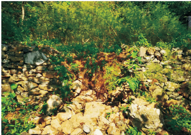
图5 西大峪谷坊损毁
