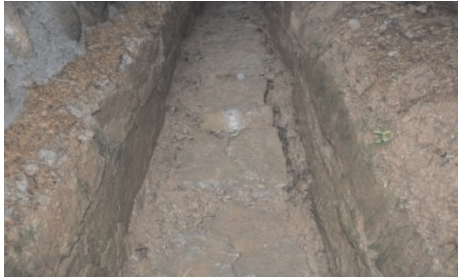
图 10 L3 裂缝引起渠道开裂
