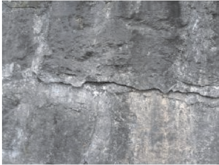
图 3 BX1 挡墙中上部横向剪切裂缝
