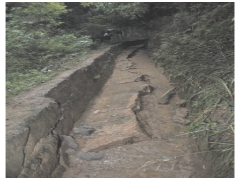
图 8 L1 裂缝引起渠道开裂
