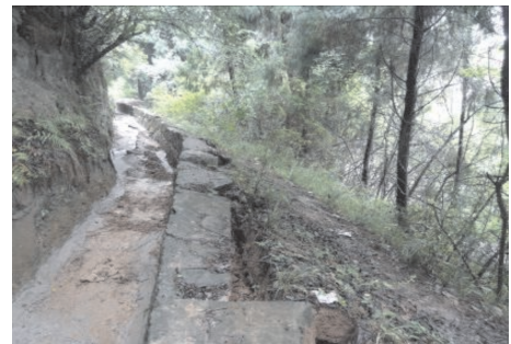
图 9 L2 裂缝引起渠道开裂
