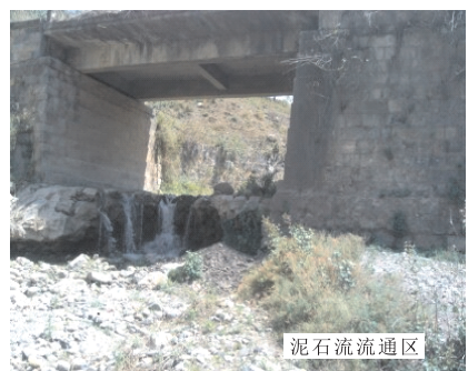
图 7 出口被泥石流掏空
