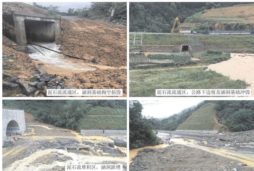
图 1 涵洞毁损、淤埋
