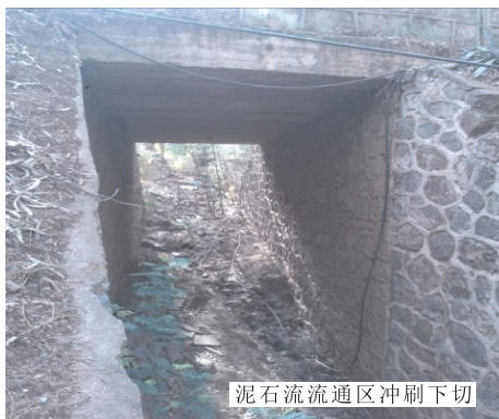
图 9 涵基受冲刷下切严重
