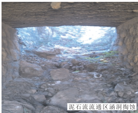
图 10 涵洞受掏蚀严重
