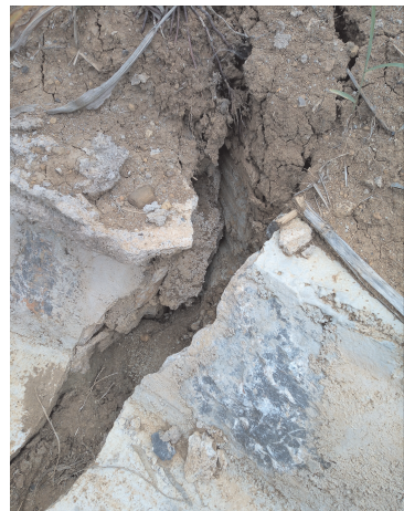
图 2 原治理水沟严重变形破坏
