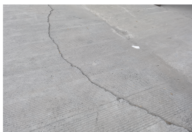
(a) 地块B地面裂缝
