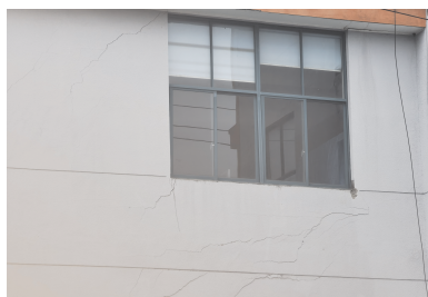
(b) 地块B厂房裂缝
