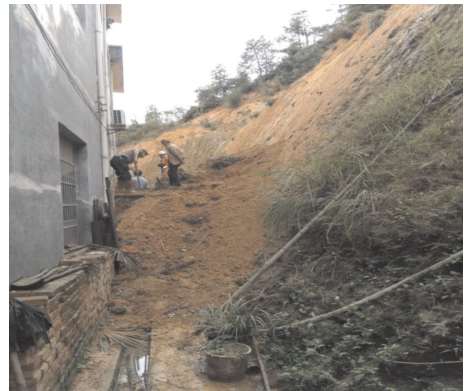
图9 于都县祁禄山镇坑溪村崩塌抢救照片
