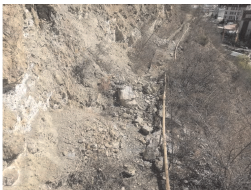
图5 滑坡中部坍塌掩埋水沟
