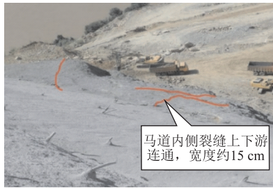
图 7 1 400 m 高程马道处裂缝
