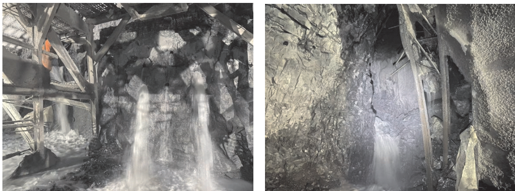
图 1 莲峰隧道出口段掌子面 ZK29+769 涌水现场照片
