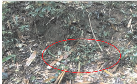
图 6 不稳定斜坡后缘裂缝
