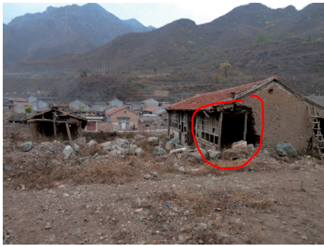
图3 房屋墙体被砸出的窟窿(镜向西)
