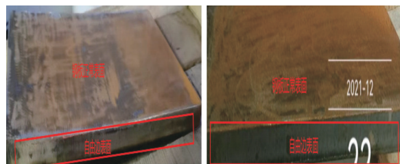
图2 4# 试板钢板表面锈蚀形成状态与自由边锈蚀形成状态对比
