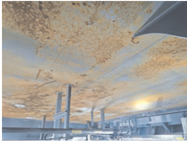
图2 压载舱顶板浮锈
