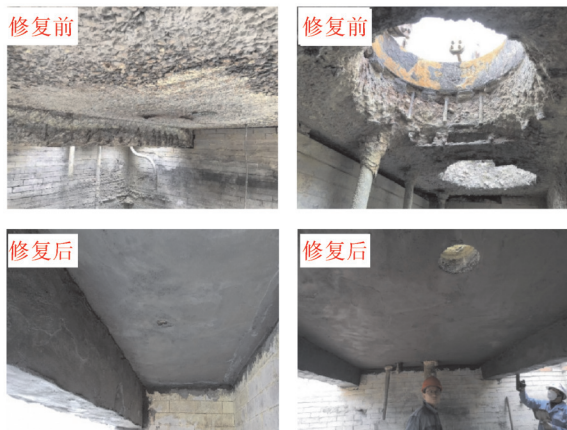
图 1 混凝土防碳化修复效果
