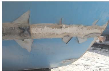
图 4 某项目焊缝反面热影响区
