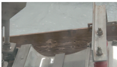
图1 铜排表面的麻点和凹坑
