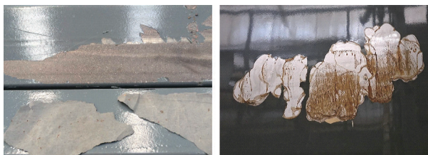
图5 涂层脱落(左:铝基材;右:碳钢基材)
