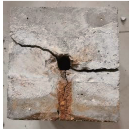
图8 钢筋拉拔试验试件的破坏形态
