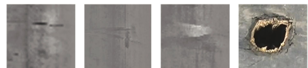
(a) 裂纹 (b) 磨损 (c) 鼓泡 (d) 孔洞
