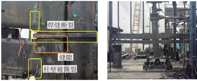
a) 试件SC1试验破坏模式 [23]
