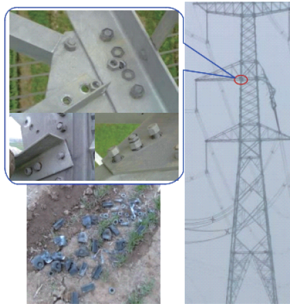
图1 输电塔灾害实例 [6]
