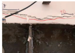
e) 板1底部裂缝与背面前后贯通露出网络布
