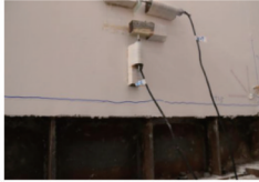
b) 板3到板5底部饰面层出现裂缝
