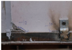
d) 背面板1底部连接件处出现裂缝且板角出现裂缝
