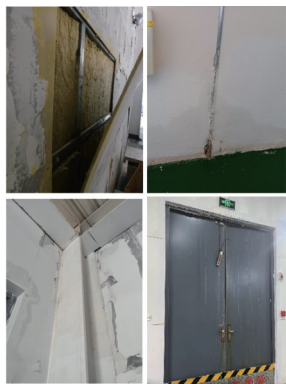
图1 轻钢龙骨装配式复合墙板渗漏现象
