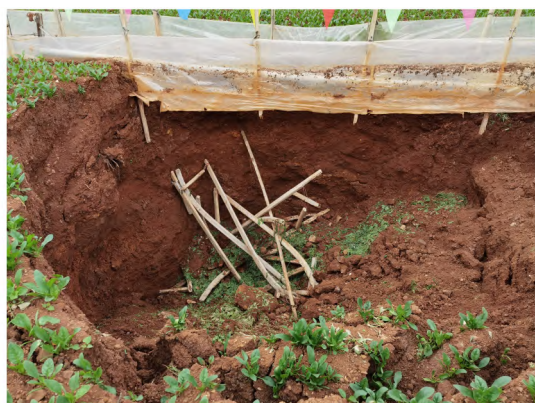
图 6 小扑隧洞在阳新组( P_1y )灰岩段施工引起的地面塌陷
