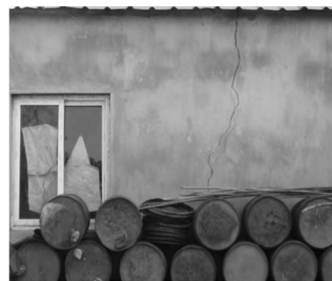
照片2 现状调查评估区内发现多处房屋开裂现象,开裂宽度 0.5~3.5cm,呈“上宽下窄”,开裂长度 0.5~2m,横贯整个房屋开裂方向一般与地面垂直,开裂位置位于房屋中部,具备因软土变形引发房屋开裂的特征。
