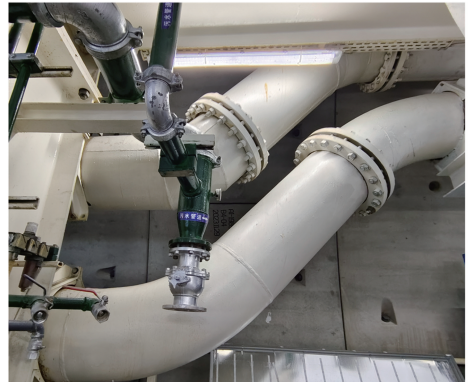
图 4 现场泥浆管路 Fig.4 Slurry pipeline
