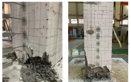
(c) 柱脚混凝土压碎
